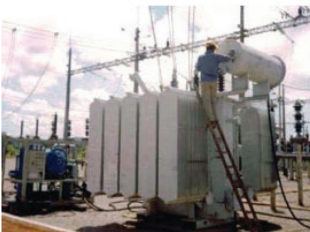
Figura 11 – Termo-vácuo filtrando trafo
