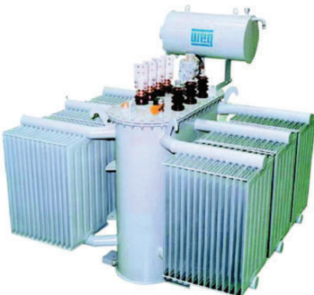
Figura 91: Transformador de Potência.
