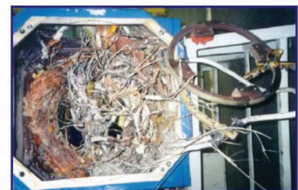
Figura 88: Motor CC danificado por disparo.
