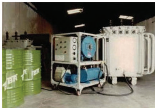
Figura 10 – Termo-vácuo filtrando trafo
