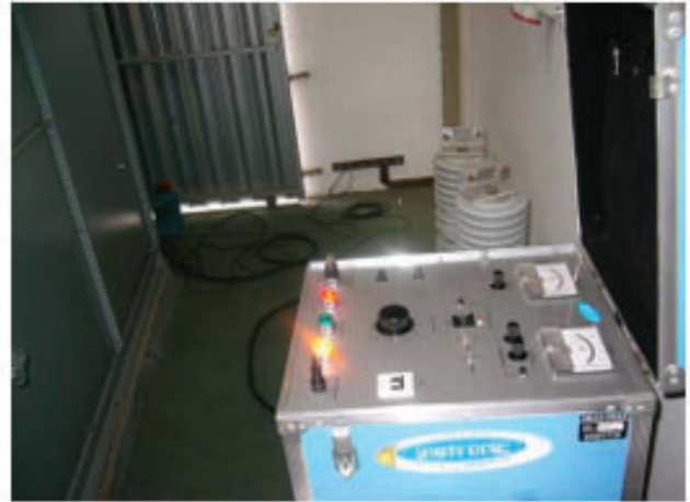
Figura 61: HI-POT 100 KV – Etapa de comando
