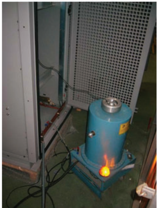
Figura 62: HI-POT 100 KV – Etapa de força.
