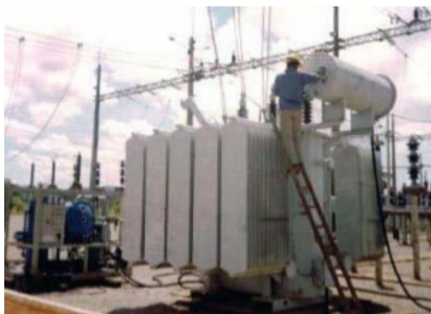
Figura 11 – Termo-vácuo filtrando trafo
