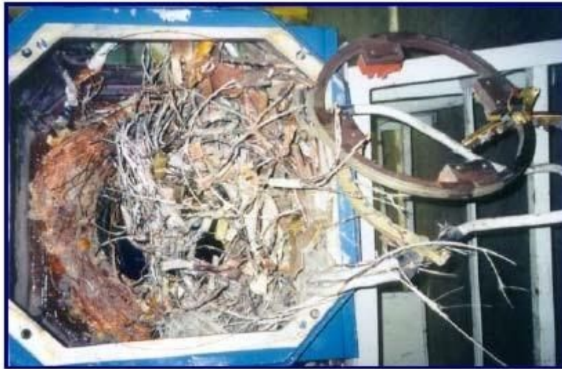
Figura 88: Motor CC danificado por disparo.
