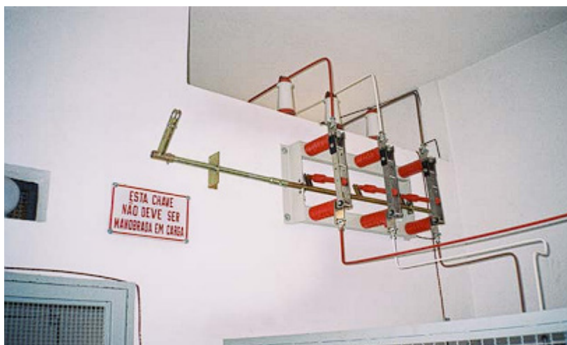
Chave seccionadora típica de uma subestação industrial interna
