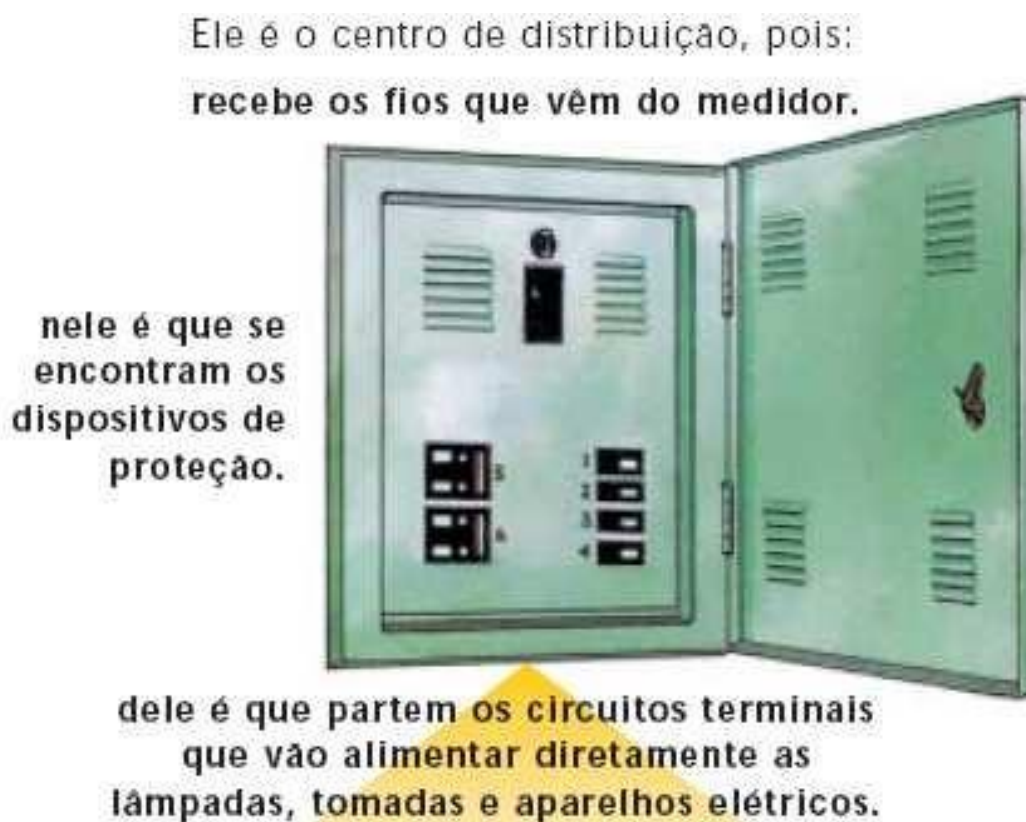
Figura - Quadro de distribuição
