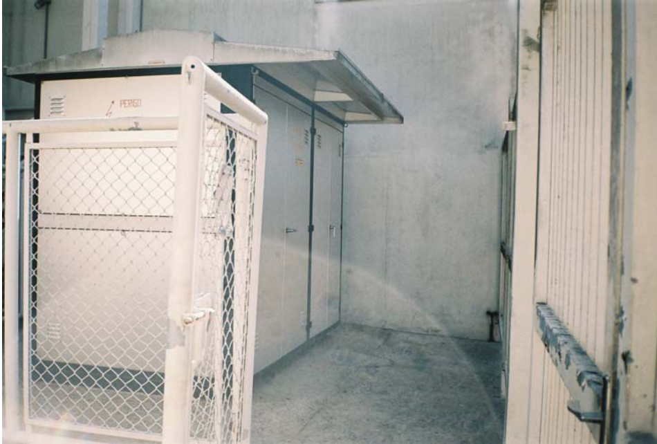
Vista de uma subestação industrial do tipo blindada
