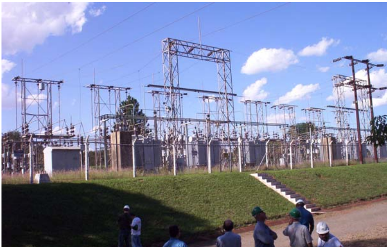
Subestação típica de transmissão de energia elétrica.
