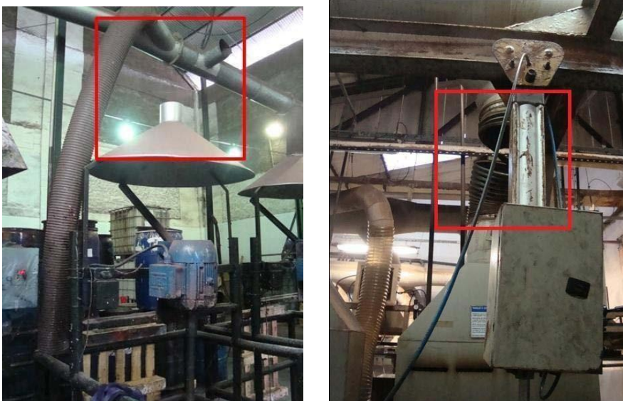
Figura 1: Observa-se, à esquerda, que o captor não está conectado ao duto do sistema da ventilação exaustora, estando assim inoperante; à direita, observa-se a interrupção do duto do sistema de ventilação local exaustora (SVLE).
