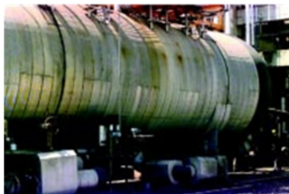
Figura 18 - Dessalinizador ou Dessalgadora - REPAR - Araucária - PR.
